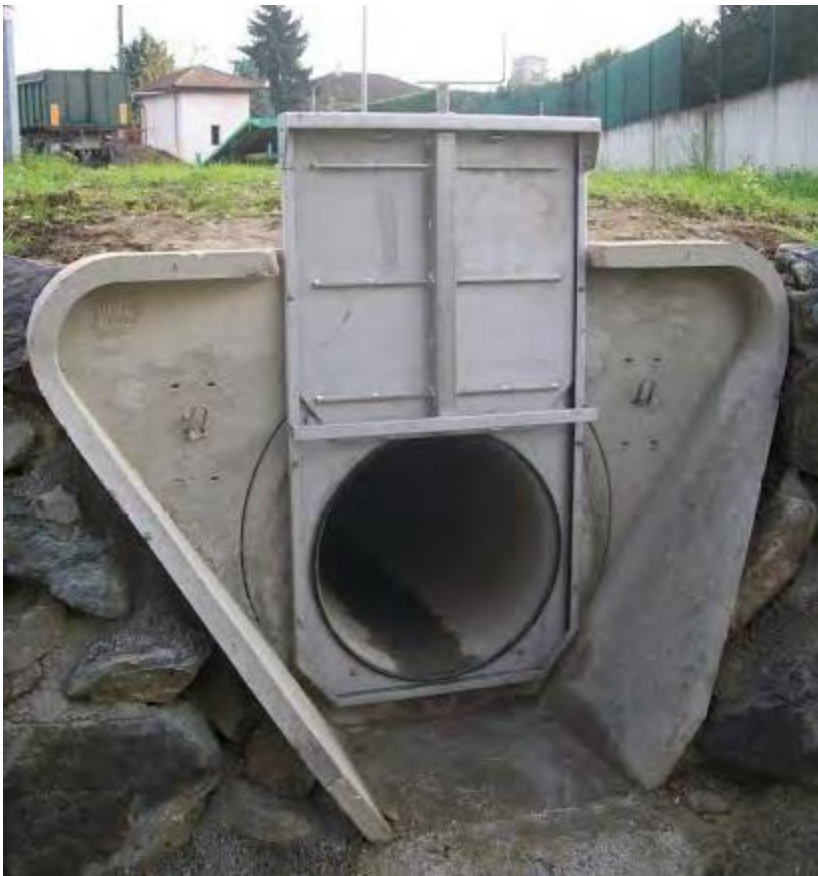
Exemple de vanne martelière située au droit d'un ouvrage de rétention
